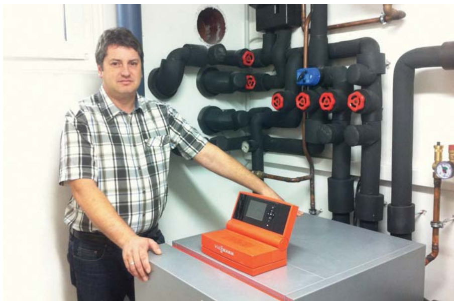
Bei Familie Brandstötter-Luger sorgt die erste Eisspeicher-Anlage Oberösterreichs für angenehme Temperaturen im Haus.
